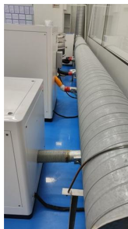
设备废气收集装置
