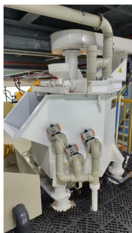
设备废气收集装置
