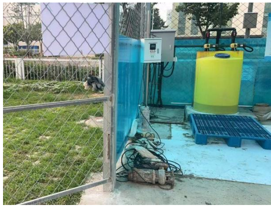
均质消毒池（位于地下）及加药罐
