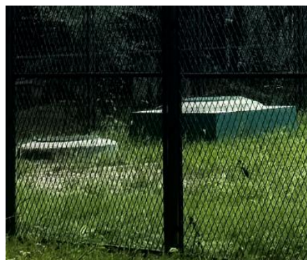
水源井位于地下
