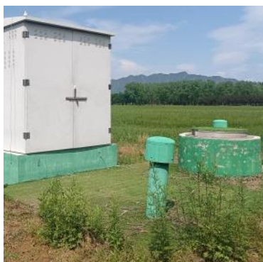
水源井位于地下
