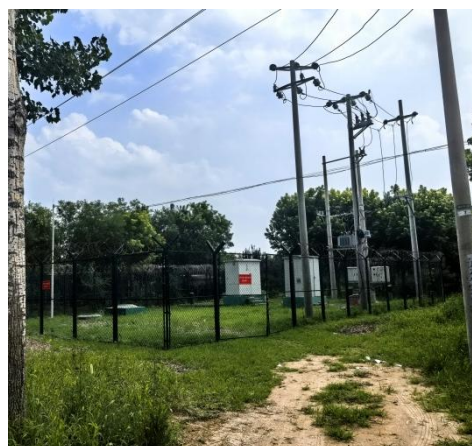
全地下泵房及控制柜
