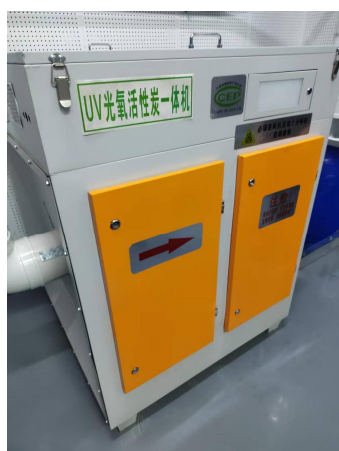
活性炭废气净化设施
