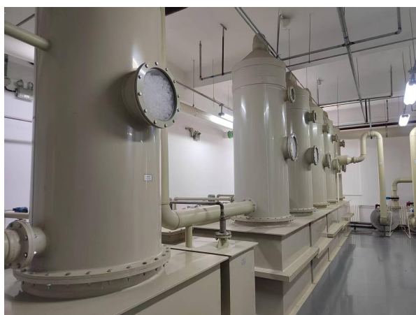
环氧乙烷废气吸收净化设施
