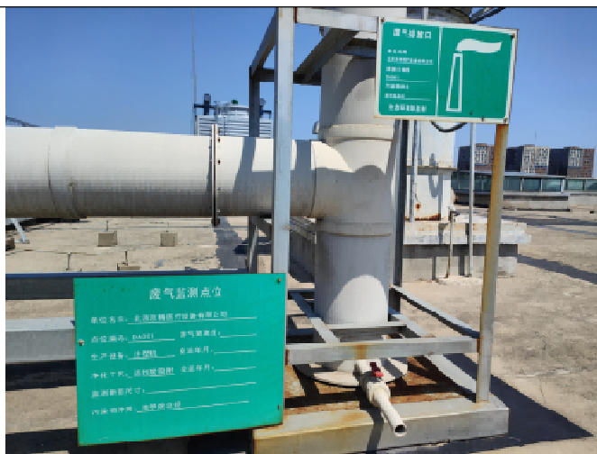
废气排放口及标识
