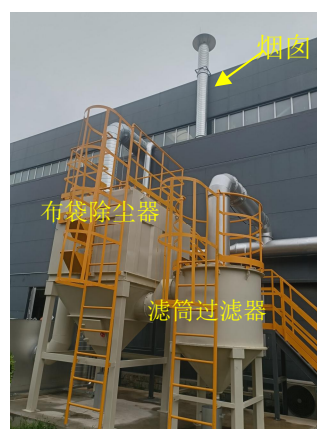
真空炉净化系统
