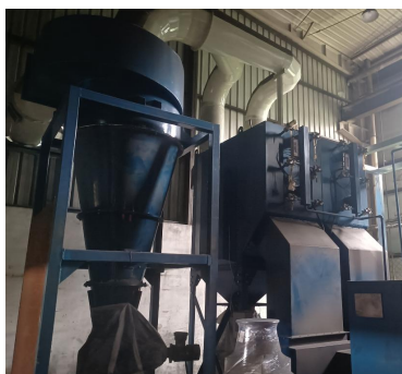
抛丸废气净化装置
