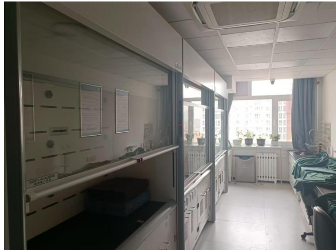
废气净化装置和实验室通风橱
