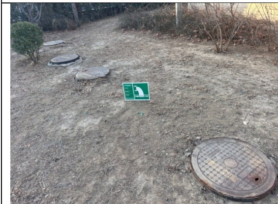
1#化粪池 (A区)
