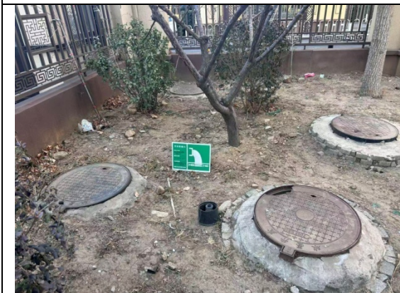
3#化粪池 (B区)
