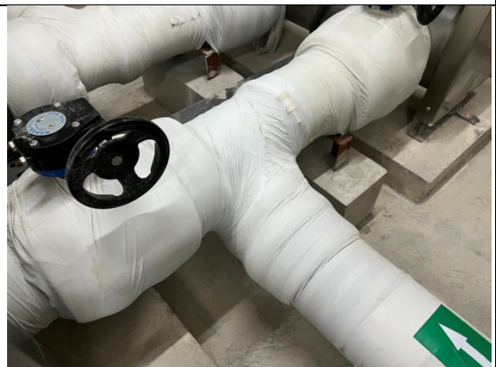
管道连接处软连接
