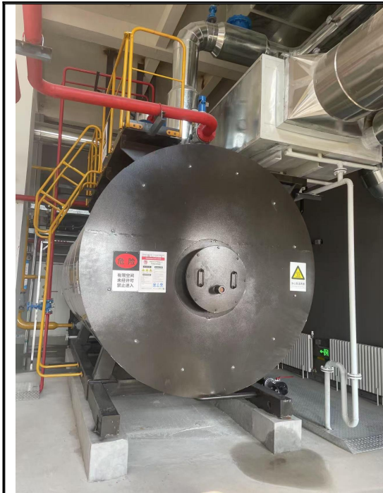
4.2MW 的燃气热水锅炉
