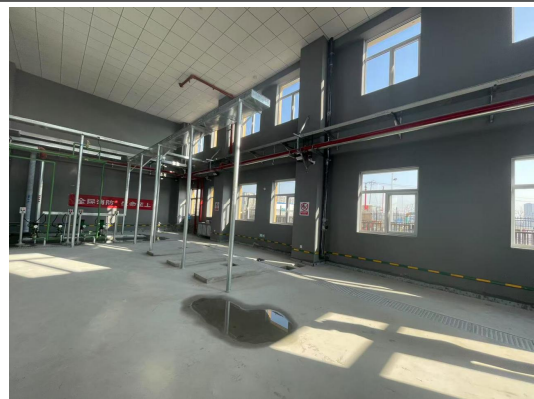
后续配套泵类等设备安装区
