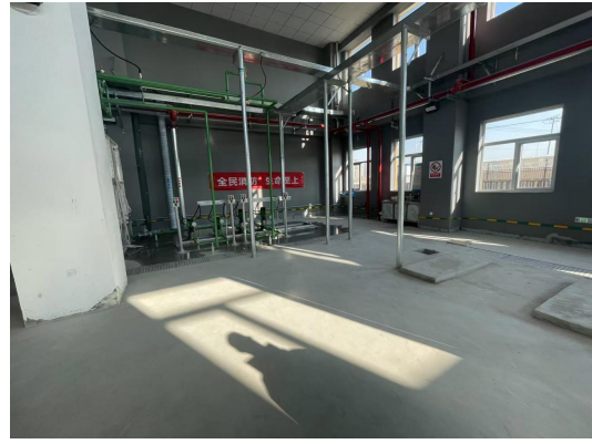
站内泵类布置区
