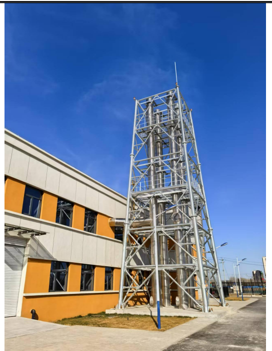
锅炉废气排气筒
