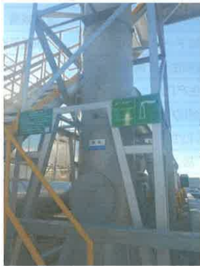
有机废气排气筒
