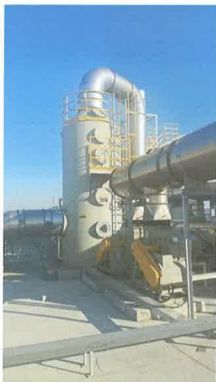
碱性废气洗涤塔
