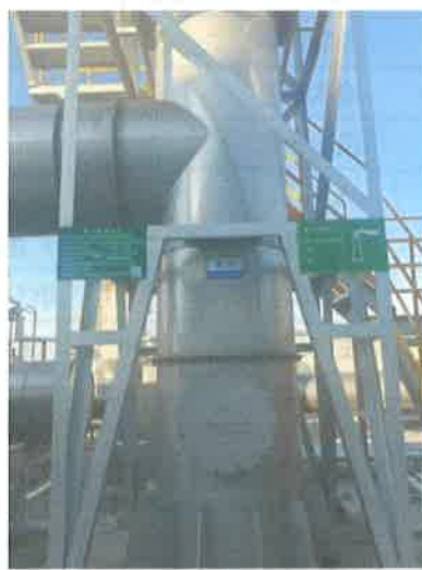
酸性废气排气筒
