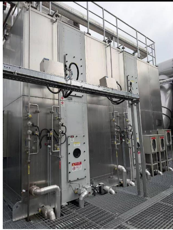
有机废气处理装置-沸石转轮浓缩吸附装置
