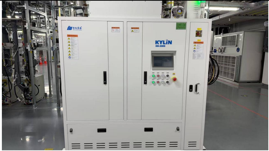
POU 设备-燃烧水洗装置
