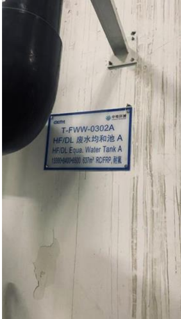
含氟废水处理系统
