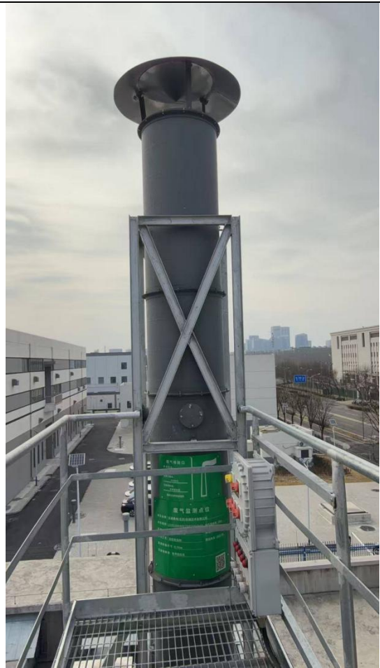
危废仓库废气排气筒 DA805
