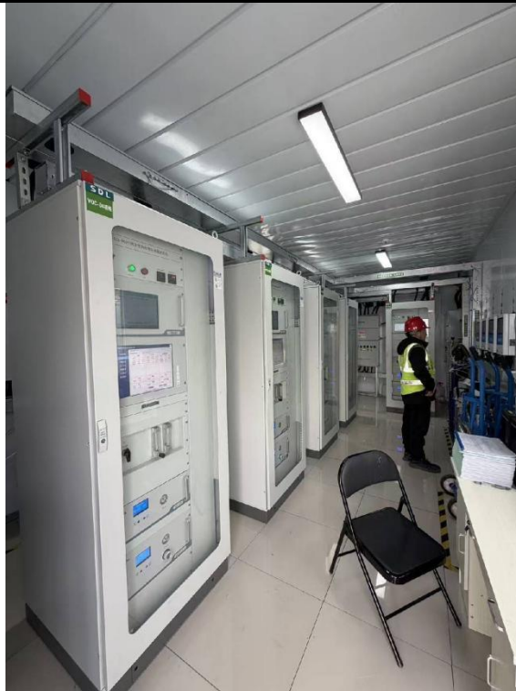
有机废气排放口在线监测设备 4 套
