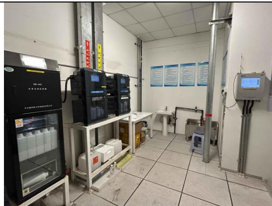
废水排放口在线监测设备
