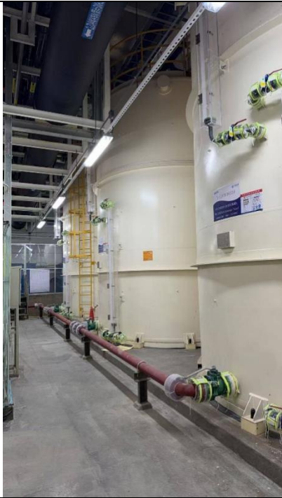
废酸液暂存区
