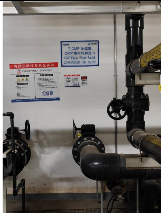
研磨废水处理系统
