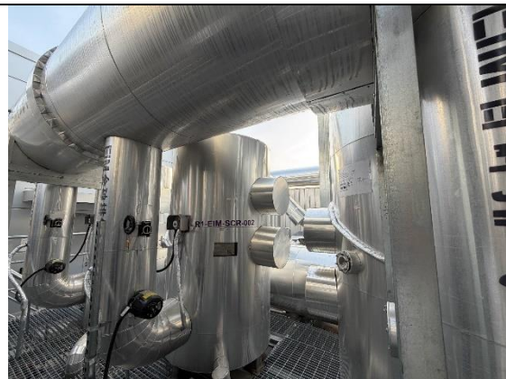
含砷废气处理装置-干式吸附装置
