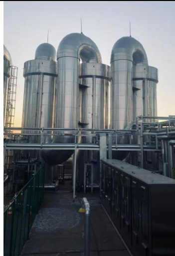
水处理氨氮吹脱塔
