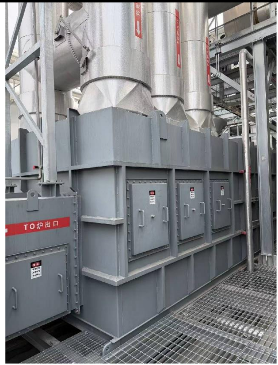
有机废气处理装置-焚烧炉装置
