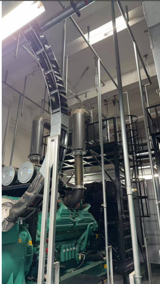
排烟管道消音箱（柴油发电机房）
