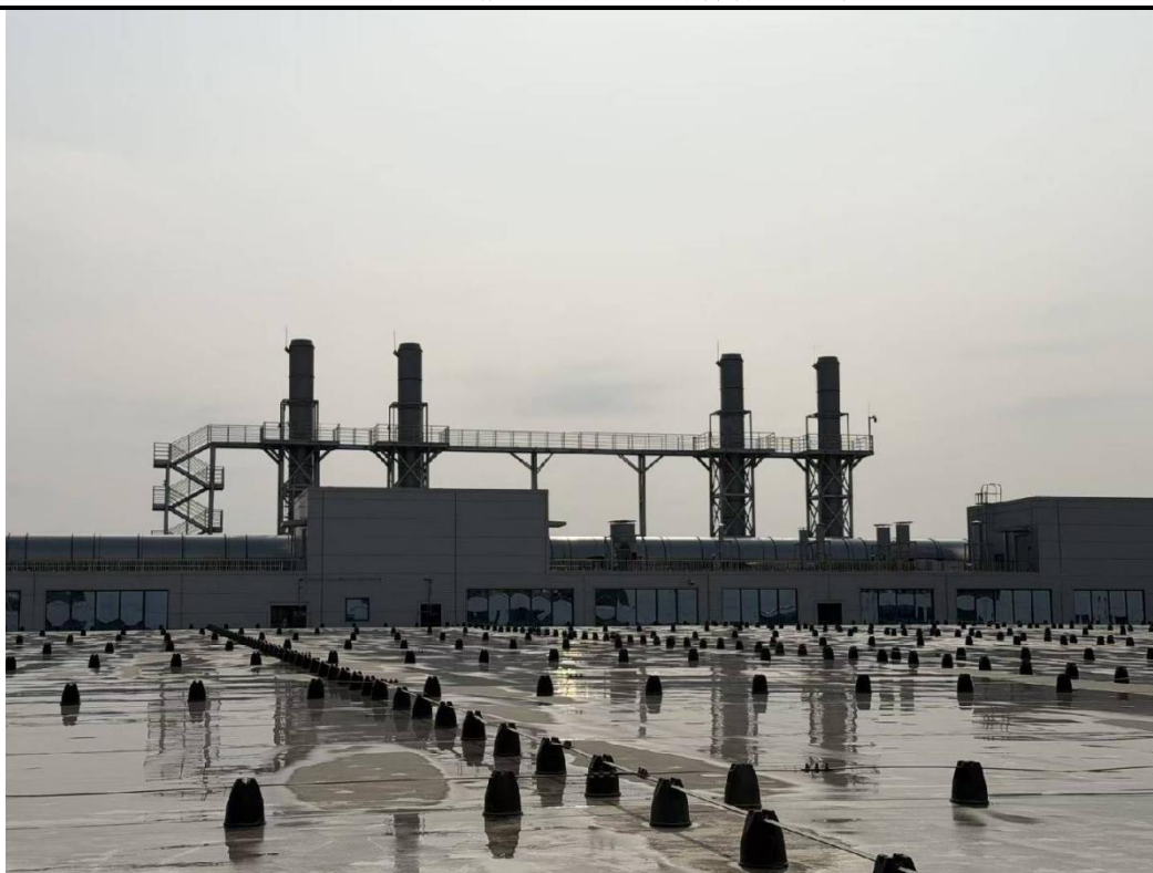
生产厂房 3（FABC1C）南侧排气筒总览图
