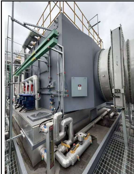
酸性废气处理装置-碱液喷淋塔
