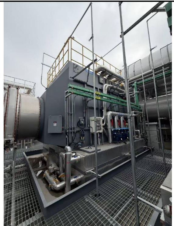
碱性废气处理装置-酸液喷淋塔
