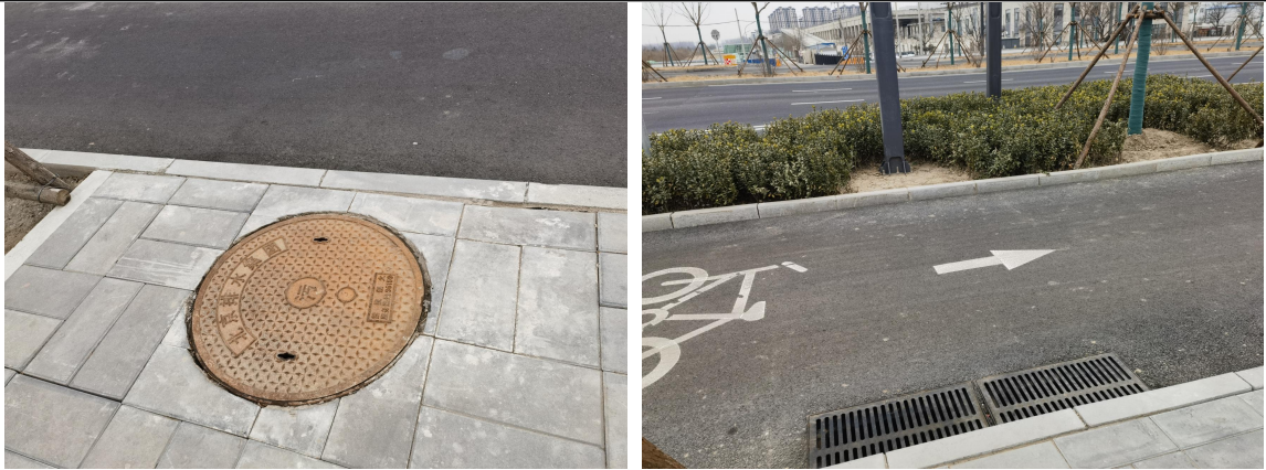
污水井及雨水篦子
