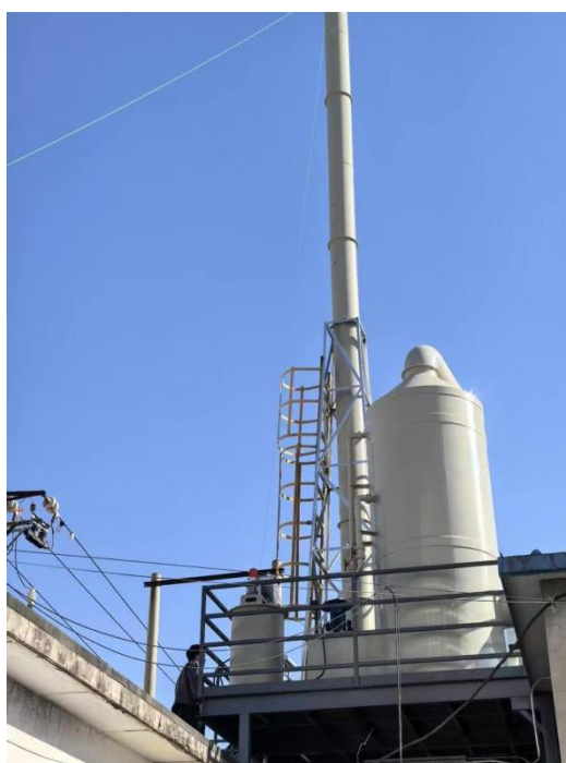
喷淋塔（5#厂房） 喷淋塔排气筒（DA002）
