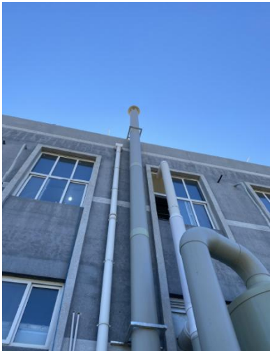
喷淋塔排气筒（DA001）
