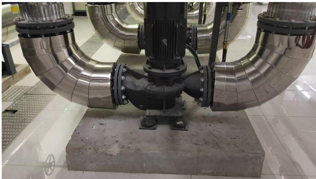
水泵减振支座及软连接
