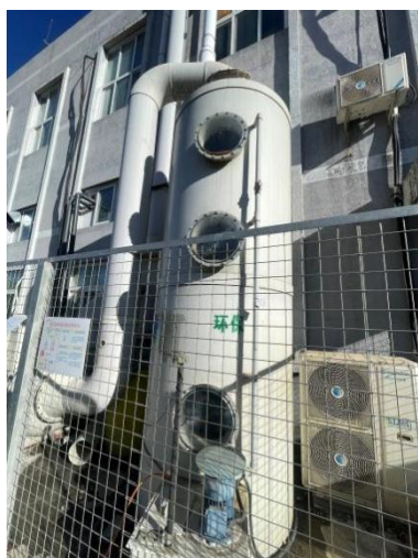
7#厂房废气洗涤塔
