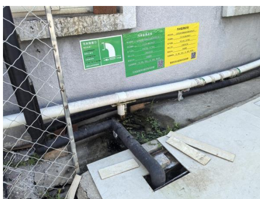
污水排放口标识
