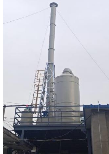
DA002 排气筒及净化设施
