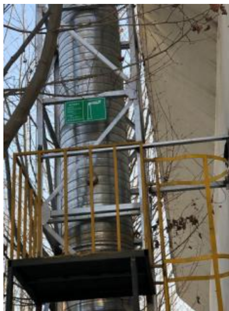
废气排放口标识
