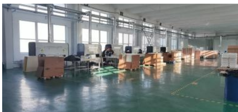
车间排风系统 1
