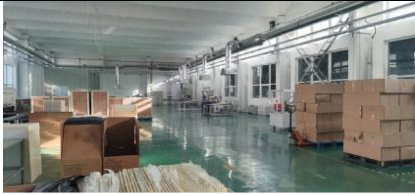
车间排风系统 2
