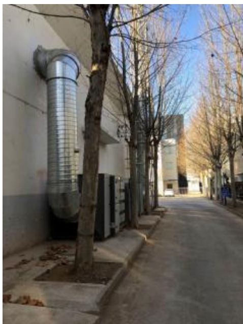
厂房东侧净化系统
