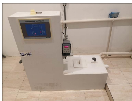
图 6-2 位于项目所在建筑二层的医疗污水消毒处理设施
