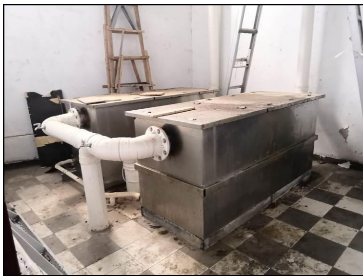
图 6-4 位于项目所在建筑内的总隔油池设施
