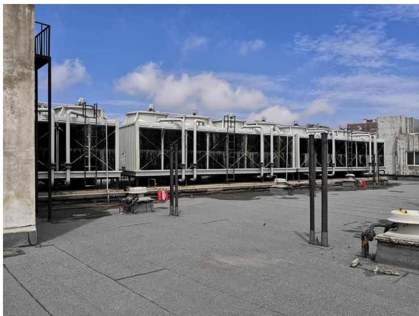
图 8-1 位于项目 8 层楼顶处的冷却塔设备
