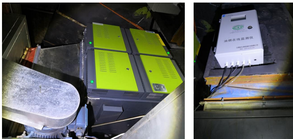
图 7-3 位于项目 2 层设备间内的油烟净化设备及油烟在线监测仪
