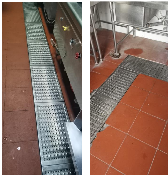
图 6-3 位于项目厨房操作间内的初级隔油设施
