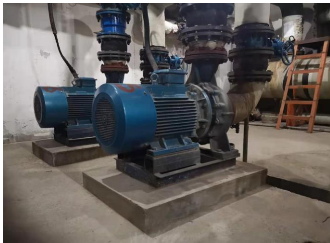
图 8-2 位于项目地下设备间内已采取减振措施的水泵设备
