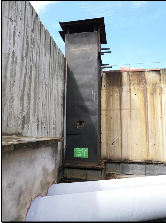
图 7-1 项目 8 层楼顶处锅炉和直燃机废气共用烟囱排口
