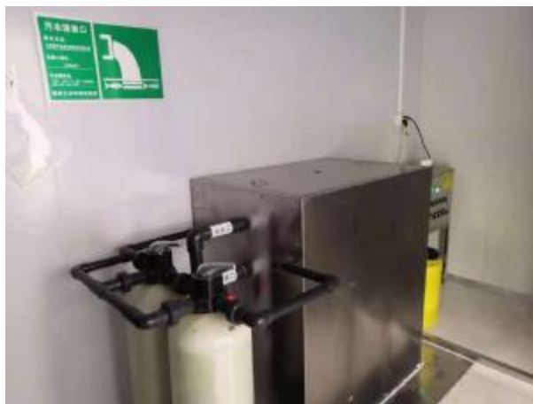
图 3-1 生产废水处理装置
