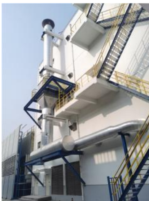
柴油发电机排气排气筒
