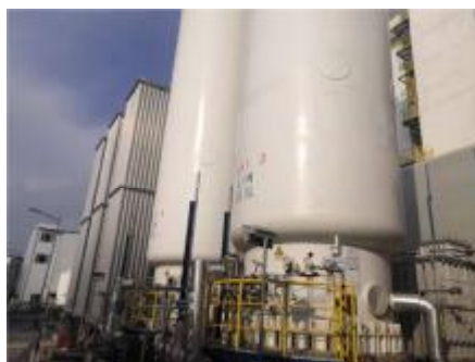
项目建成储罐及设备
