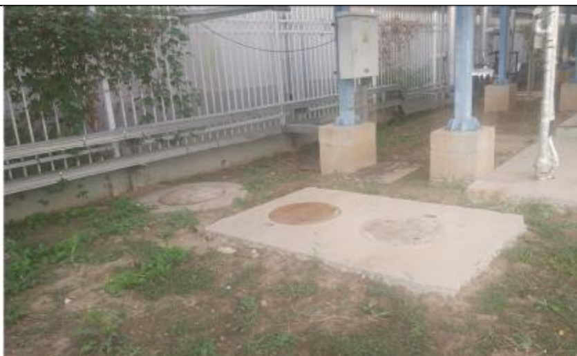
“中芯国际”化粪池排口（排入中芯国际管网）
