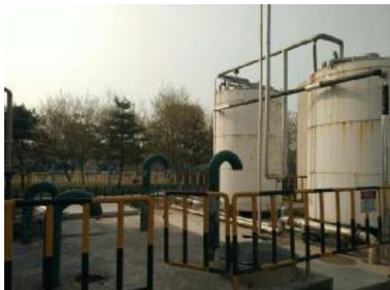
图 2-3 企业现状污水站
