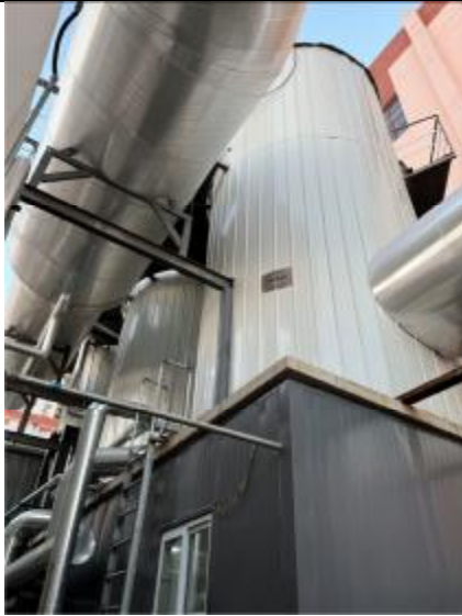
烟气余热回收装置
