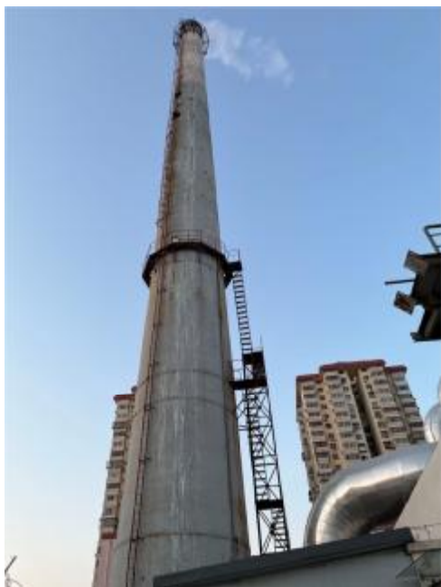
图 7 锅炉房排气烟囱
