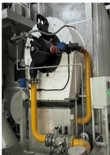
图 8 锅炉低氮燃烧器
