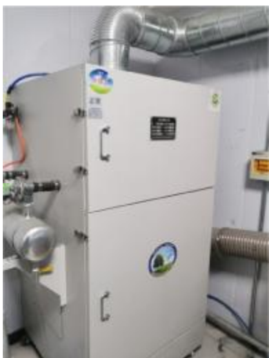
喷砂滤筒除尘设备（喷砂间内）
