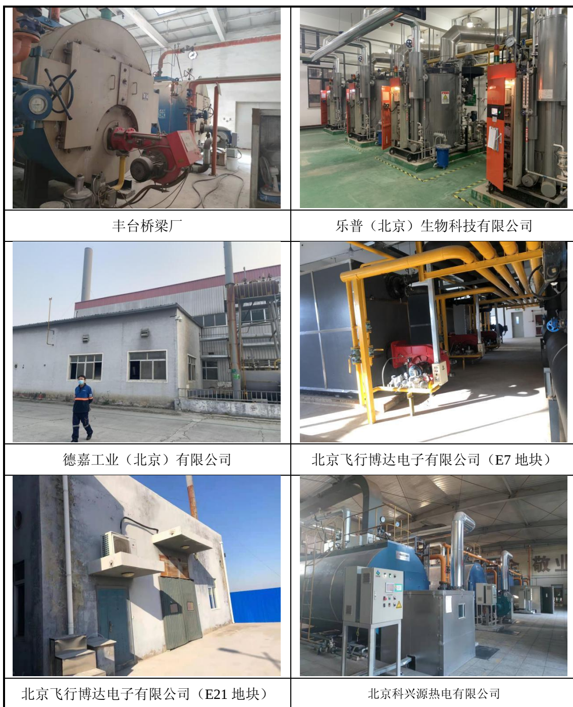
图 2.2-1 园区内锅炉现状照片
