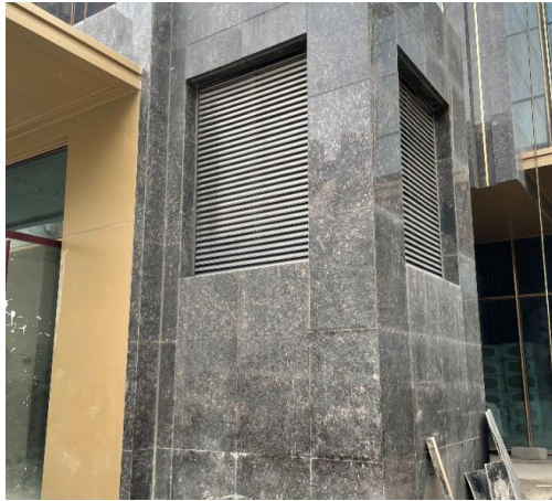
图 3-2 地下车库废气排放口
