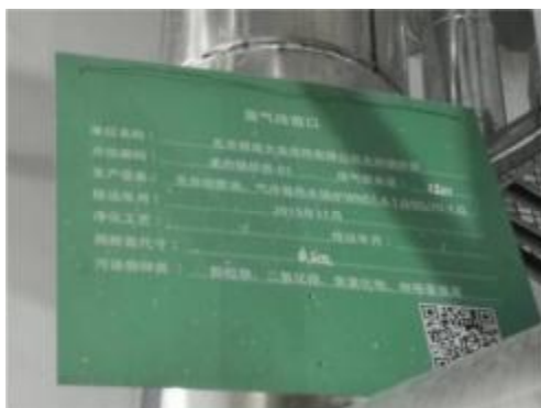
1.4MW 锅炉废气排放口标识
