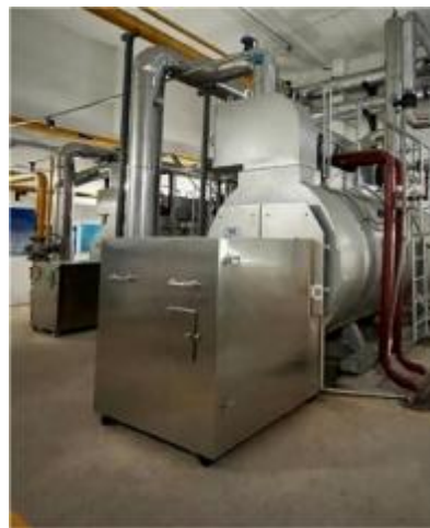
现状两台锅炉
