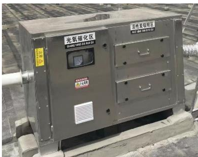
图3-3 废气净化设备
