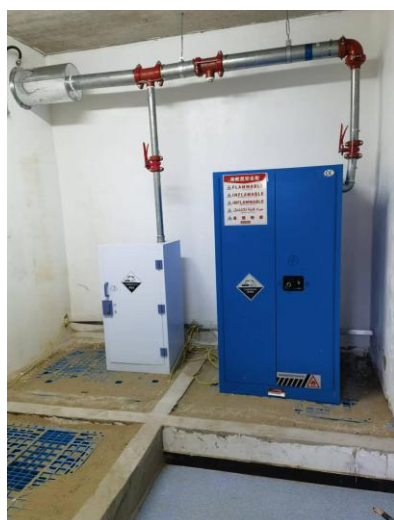
易制毒化学品存储间内部
