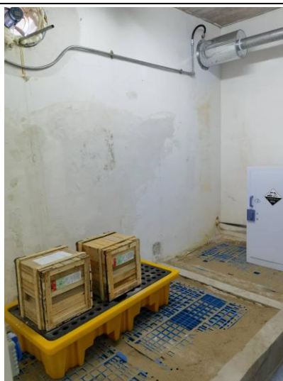
易制毒化学品存储间内部
