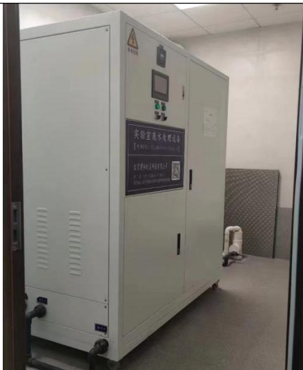
污水处理系统
