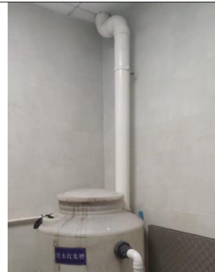
污水处理设施排气管
