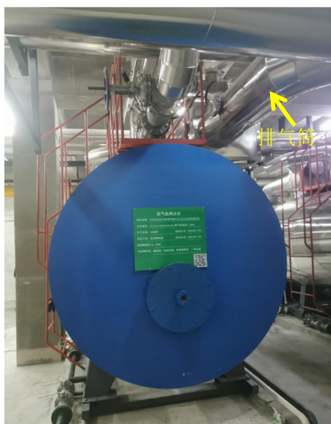
1#锅炉监测口标识
