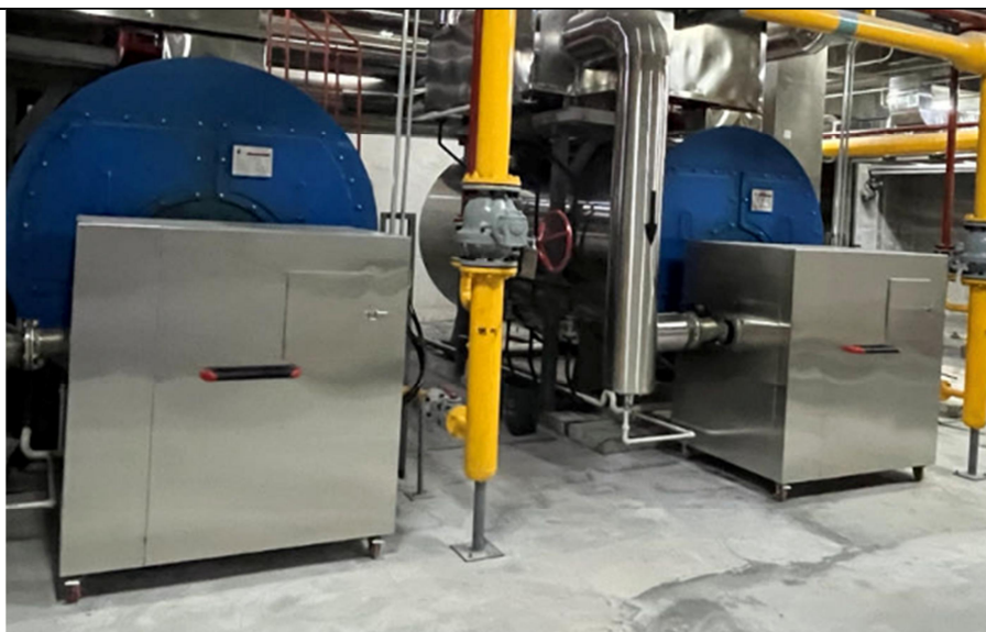
两个锅炉燃烧器隔声罩
