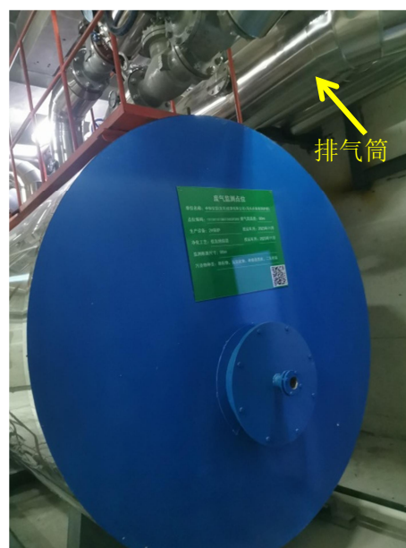
2#锅炉监测口标识
