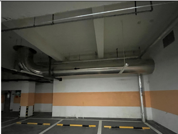
两台锅炉烟气汇合管道
