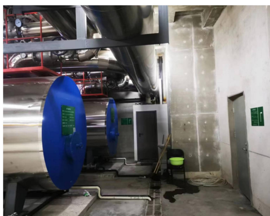
两台锅炉标识牌设置
