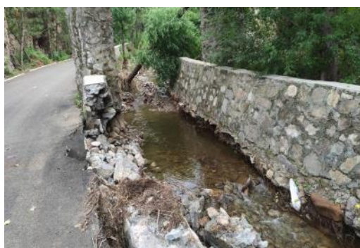
挡墙坍塌（河南沟）
