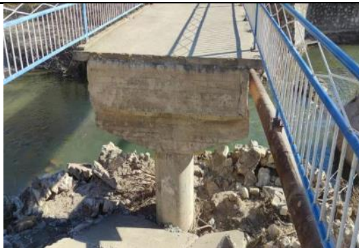
桥梁冲毁（白河）
