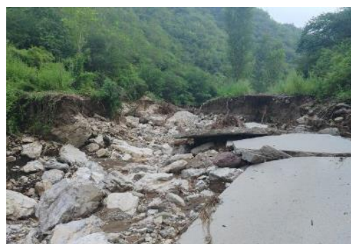
挡墙及巡河路坍塌（白河右支一河）
