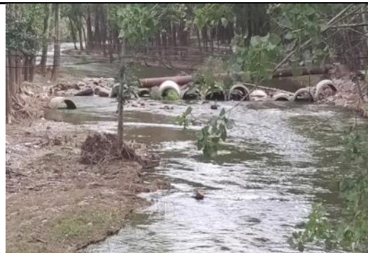
桥涵冲毁（白河）
