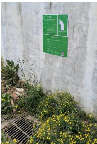
污水总排口标识
