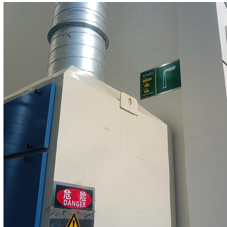
废气排放口标识
