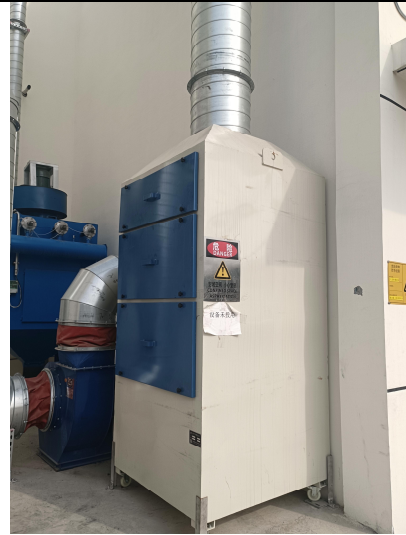
有机废气净化装置
