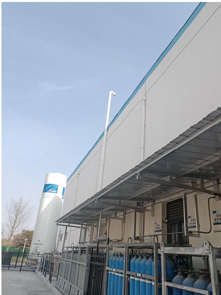
实验室废气排气筒
