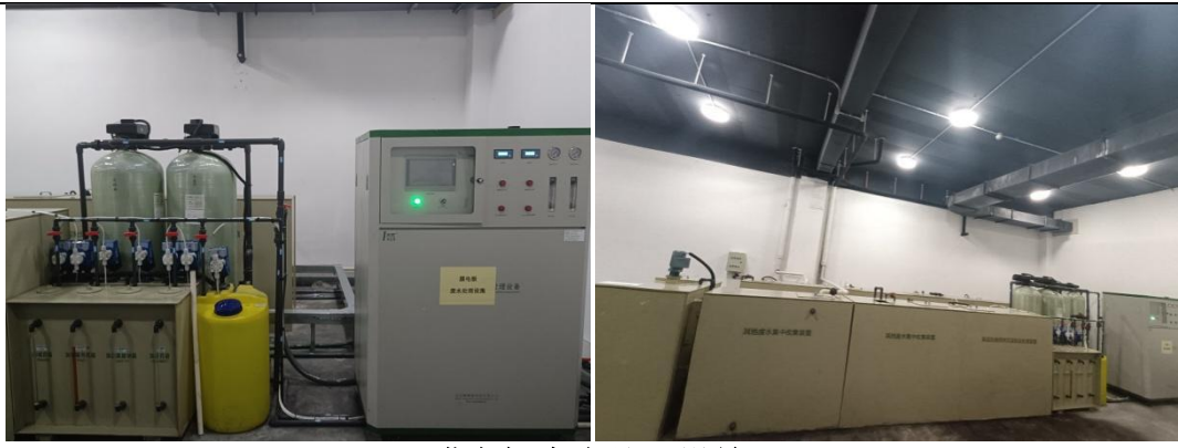
膜电极废水处理设施
