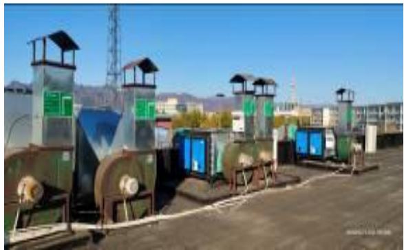
食堂废气排放口
