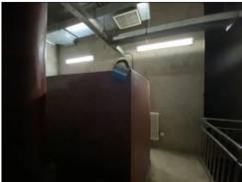
污水站废气活性炭吸附装置
