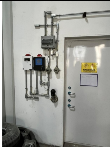
危化品库监控装置
