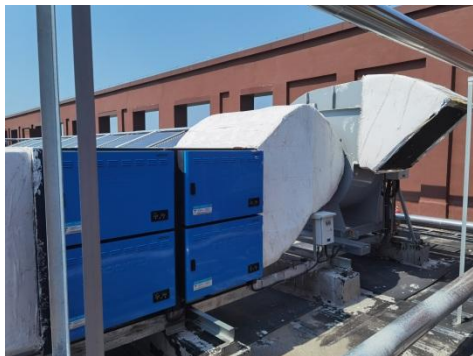
1#油烟净化装置及排气筒 (DA003)
