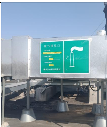
焊烟废气排放口标识（DA002）
