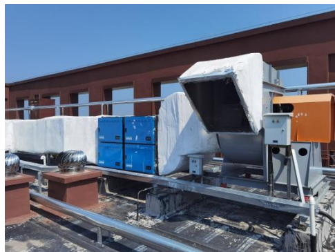
2#油烟净化装置及排气筒 (DA004)
