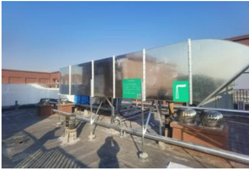
4#油烟净化装置及排气筒（DA006）
