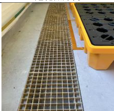
危废间内废液收集槽
