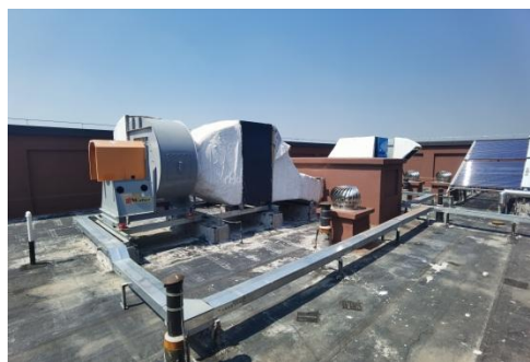
3#油烟净化装置及排气筒 (DA005)
